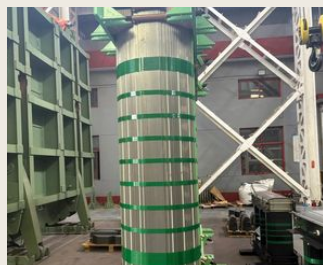
PRJ-01 330 kV 超高压变压器铁芯
