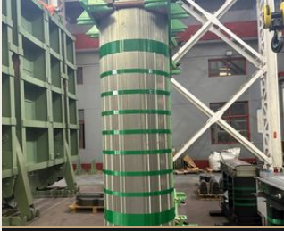
PRJ-01 330 kV EHV transformatör nüvesi
