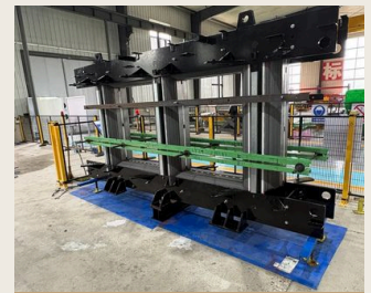
PRJ-13 Trockentransformatorkern · XD
