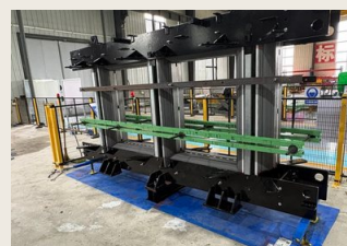
PRJ-13 Trockentransformatorkern · XD
